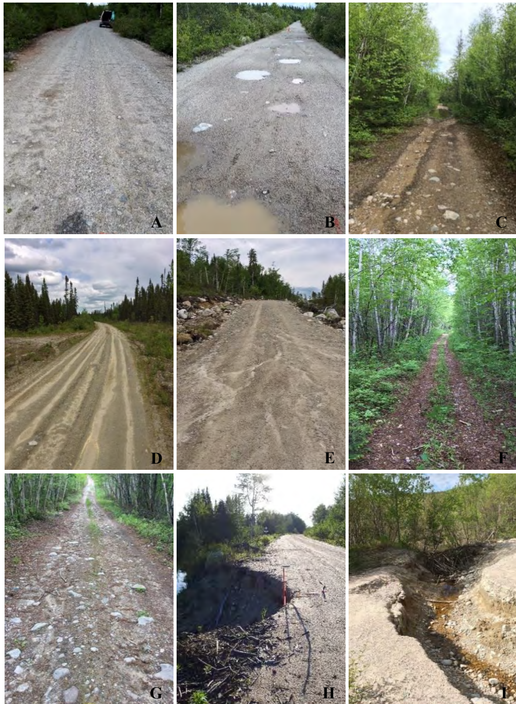
Figure 1.2 Formes de dégradation communes aux chemins forestiers en période estivale. A : Ondulations ; B : Nids-de-poule ; C : Ornières ; D : Roulières ; E : Érosion (par l'eau) ; F : Végétation ; G : Émergence de la sous-fondation ; H : Bris partiel ; I : Bris complet.
