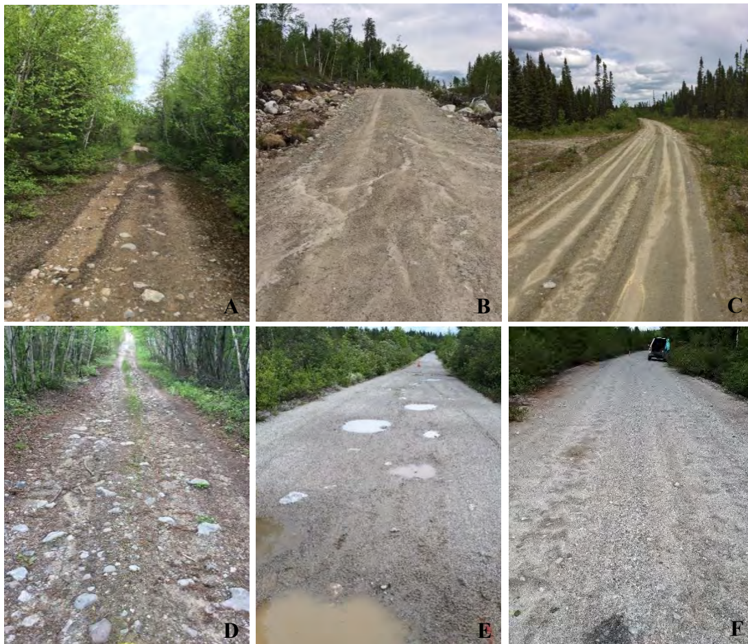
Figure 2.3 Formes de dégradation observées en ordre d'importance ; A : Ornières ; B : Érosion (par l'eau) ; C : roulières ; D : émergence de la sous-fondation ; E : nids-de-poule ; F : ondulations.
